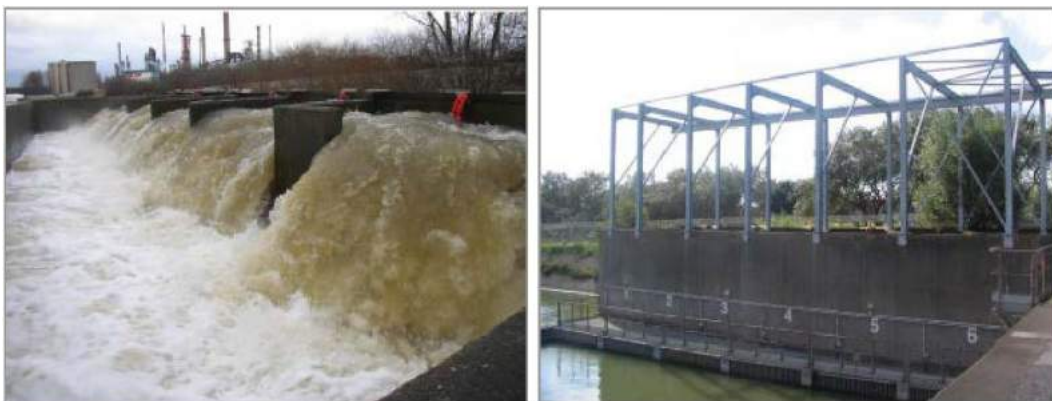
Figure 20 : Station de Mardyck (source : Institution Interdépartementale des Wateringues)
